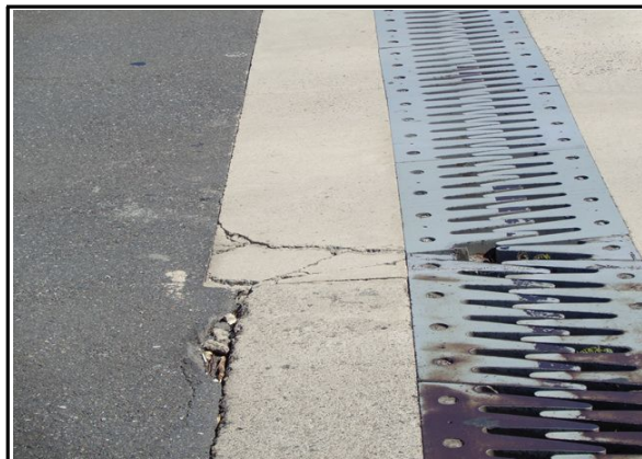
Exp12(A1) 후타재 균열
