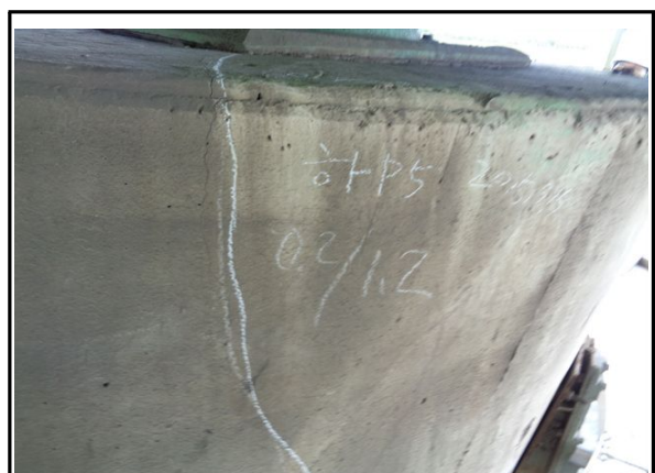
기둥부 균열 (P5)
