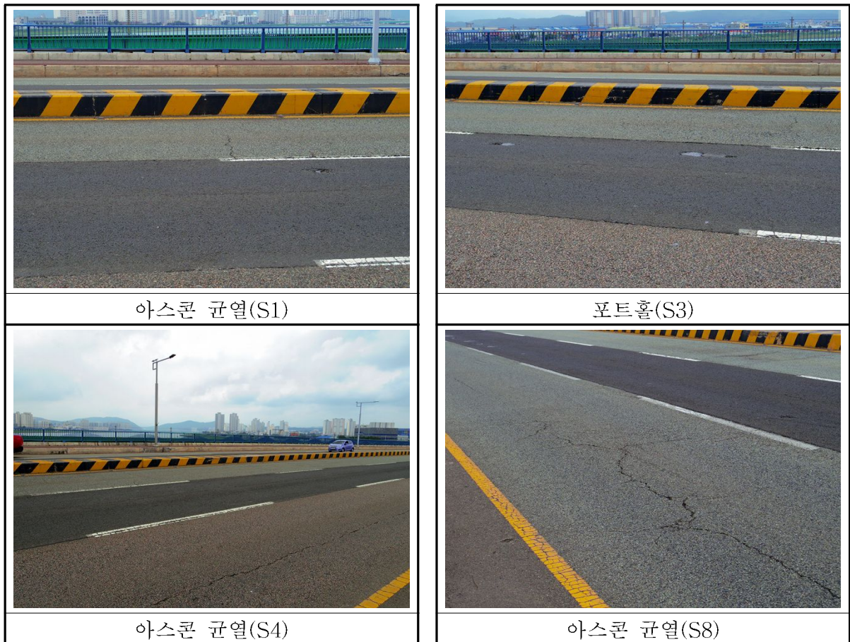
【그림 3.5】 교면포장 손상 현황
