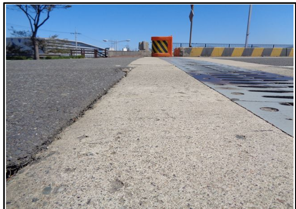
Exp12(A1) 후타재 균열
